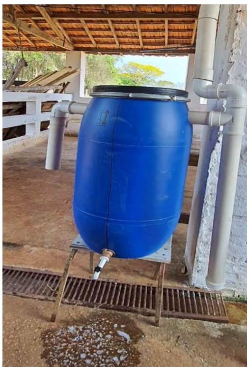
Figura 1. Cisterna montada no setor de bovinocultura e apta para uso.
