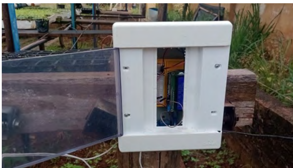
Figura 2 – Caixa de proteção com microcontrolador Arduino e display LCD instalados na horta escolar.
